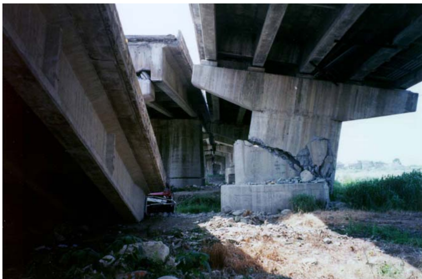
921 地震時南投草屯烏溪橋受損情形
